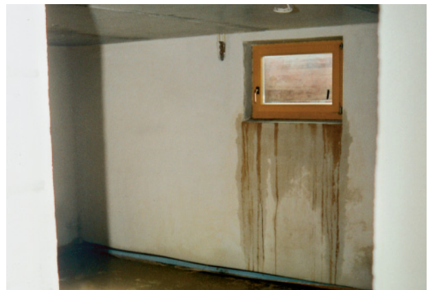
Überflutung nach Niederschlägen
