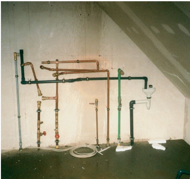
Diebstahl einer Heizungsanlage
